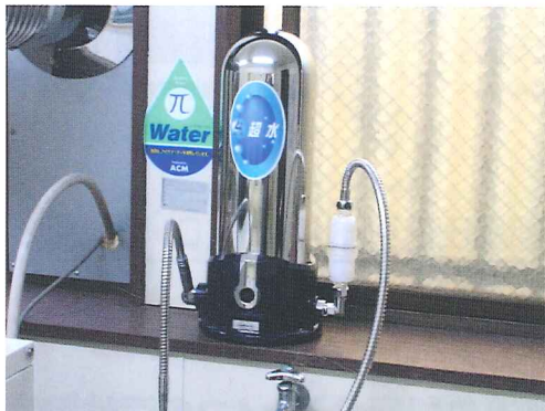
陸上競技部合宿所に設置された浄水器「超水」
