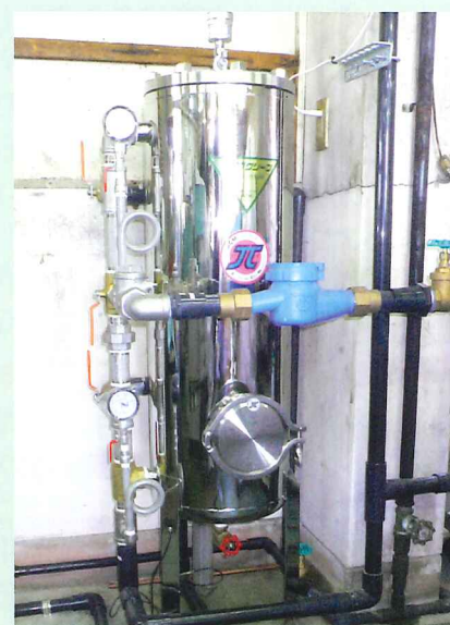
設置された浄水器「MW-11000S」
